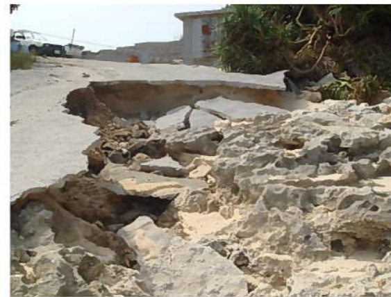
砂浜部船揚斜路の被災状況
