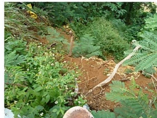
町道部路肩決壊状況
