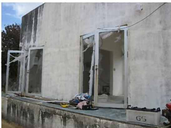
人家被災状況
