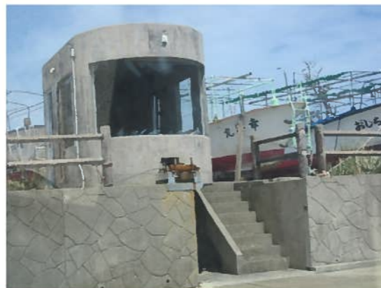
斜路操作施設の被災状況
