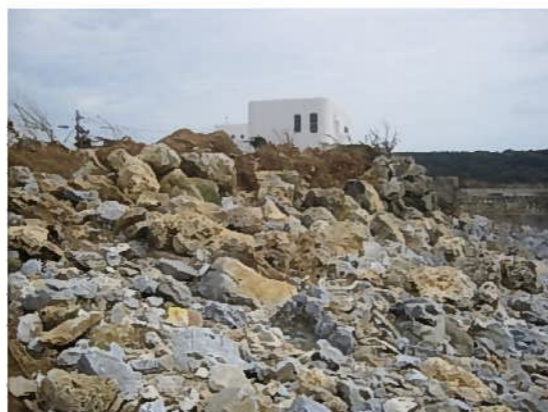
民家近くの石積護岸 崩壊状況
