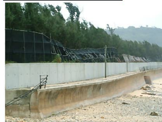
高潮と風雨による施設破損状況
