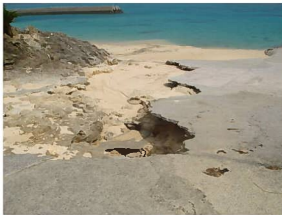
砂浜部船揚斜路の被災状況
