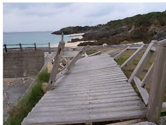
緑地ボードウォークの被災状況
