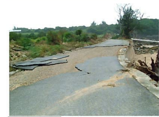
道路破損状況
