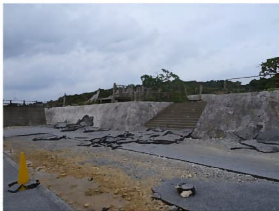
道路舗装・転落防護柵の被災状況
