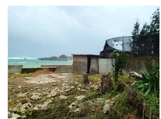
高潮と風雨による施設破損状況
