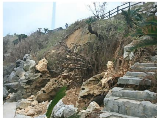
巨石積護岸の倒壊による法面の侵食
