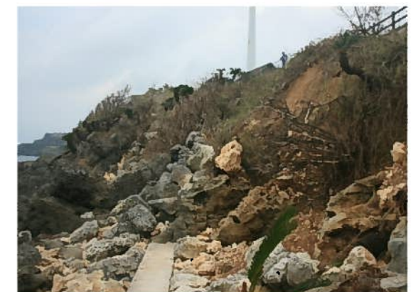
巨石積護岸の倒壊による法面の侵食
