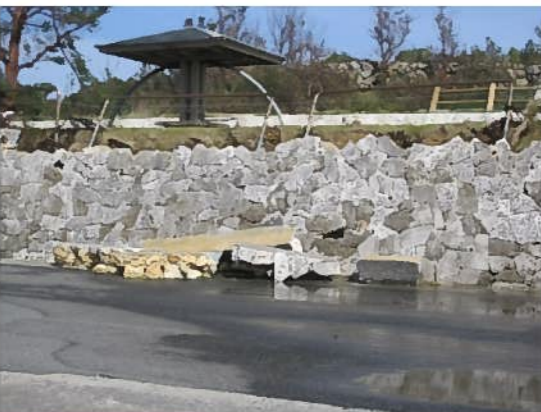
石積擁壁の倒壊
