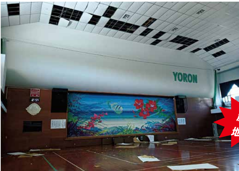
▲砂美地来館の天井の一部が落下。休館日のため、利用者はいなかった。
