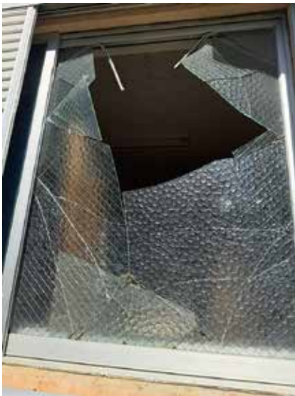
▲那間公民館の窓ガラス破損
