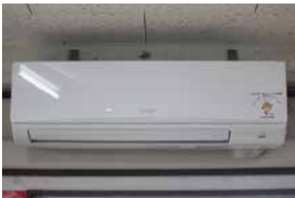
壁掛けエアコン(室内機、室外機)
