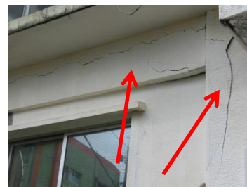
庁舎側壁・柱の亀裂
