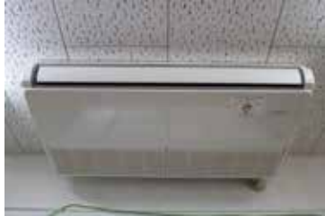
天井吊り下げエアコン
