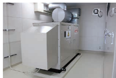
非常用発電機 定格出力 72kVA
