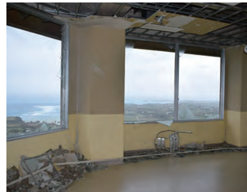
▶窓ガラスが割れたサザンクロスセンター5階（写真は被災直後のもの）
