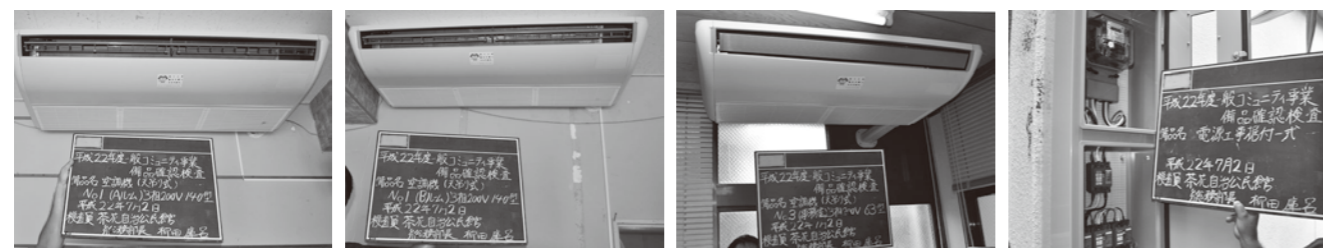
▲空調機 (140型) ▲空調機 (140型) ▲空調機 (63型) ▲空調機電源
