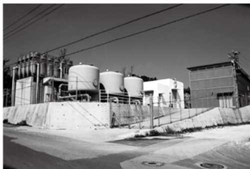
淡水化施設(平成13年供用開始)
