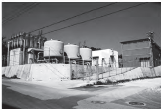
淡水化施設(平成13年供用開始)
