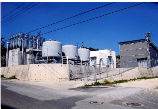
淡水化施設(平成13年供用開始)
