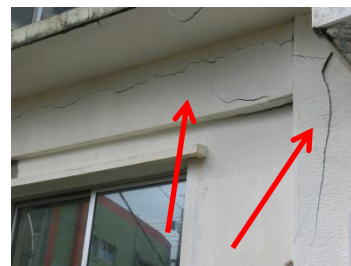
庁舎側壁・柱の亀裂
