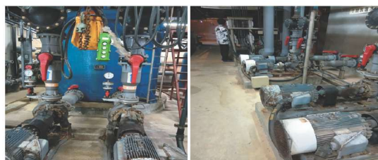
経年劣化したポンプ
