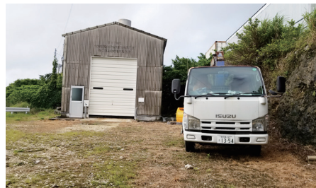
老朽化した死亡獣畜処理施設
