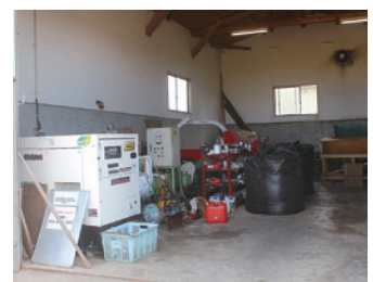
導入された発電機
