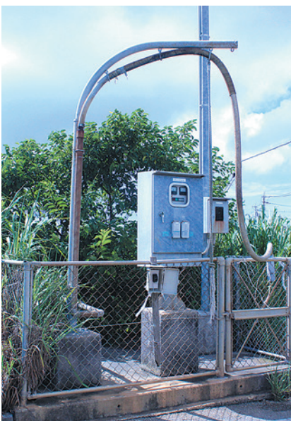
灌水対策用給水施設
