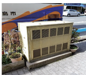
無電柱化のトランスケース
