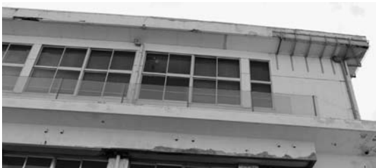
モルタルの剥離が目立つ庁舎3階
