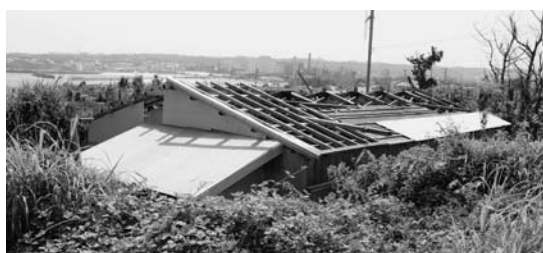
台風で屋根が吹き飛んだと畜場
