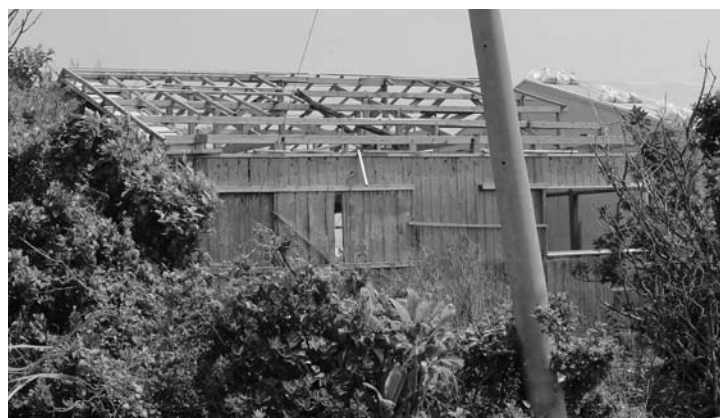
台風で屋根が飛んだ民家
