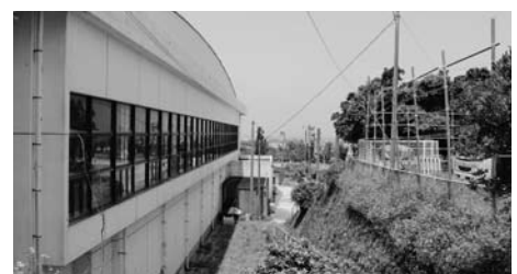
砂美地来館の窓ガラス
