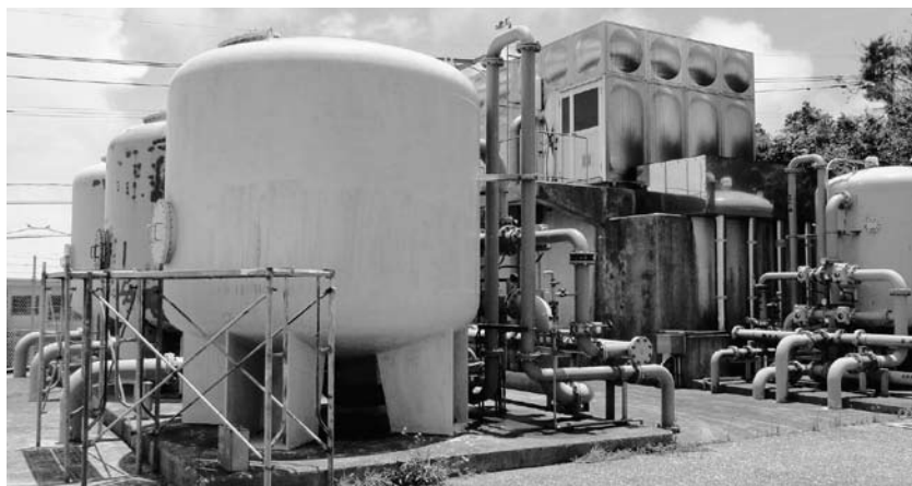
叶地区にある水道施設
